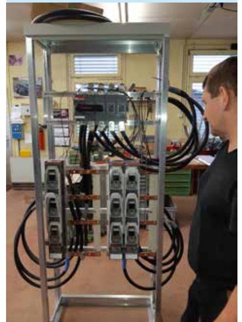
Anlage mit Ein- Ausschaltern für hohe Stromstärken.
